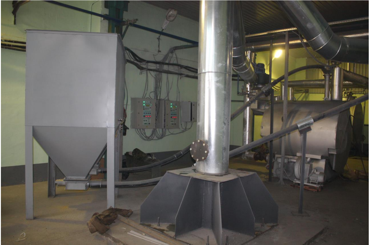
Рисунок 4 – Бункер для топлива и системы топливоподачи для двух котлов
