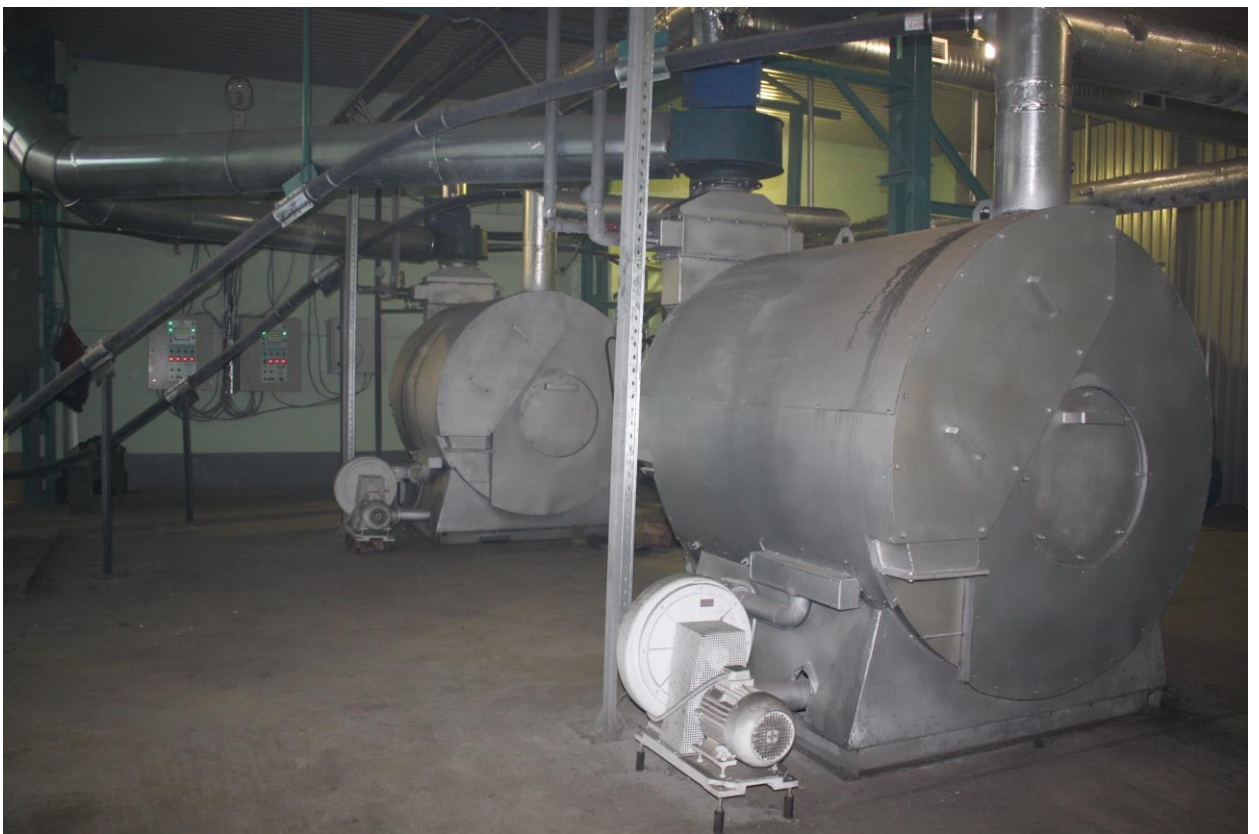
Рисунок 3 – Два котла в котельной
